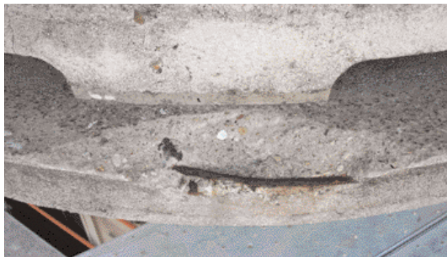
Particolare del degrado di un balcone in cemento decorativo.
